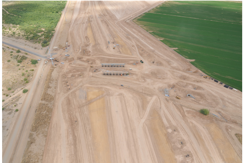
Vista aérea de la construcción de la glorieta doble en Estrella Drive
